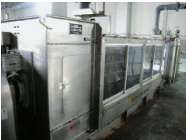
小矢部川流域下水道・二上浄化センターに導入された 圧入式スクリーブプレス脱水機
