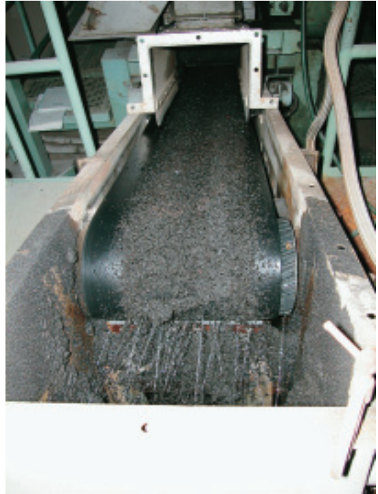
脱水された汚泥は溶融されてスラグとなり、再利用されている
