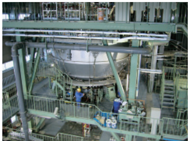
平成18年から稼働している新型溶融炉
