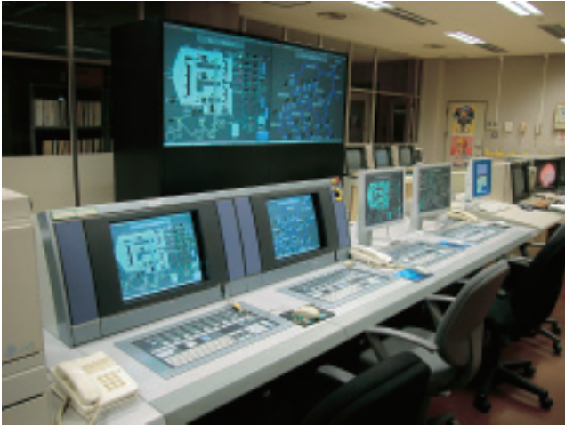
二上浄化センターのコントロールルーム
