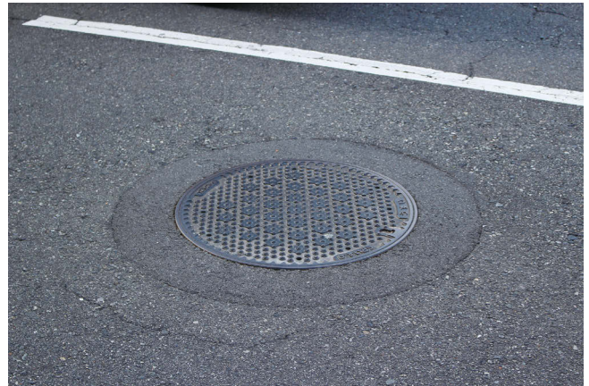
写真-1 実際に設置されている次世代型マンホール
