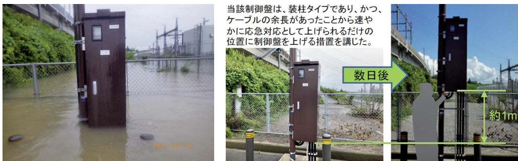
マンホールポンプ制御盤浸水状況
