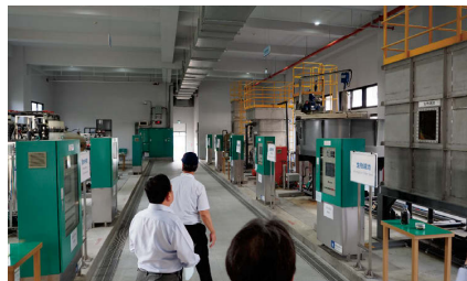
トレーニング用の浄水プラント施設
