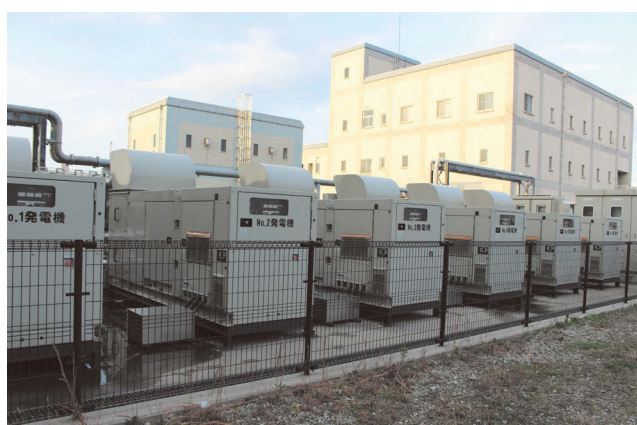
写真-1 臨海水質管理センターの消化タンク（上）、 ガスホルダ（中央）、消化ガス発電設備（下）
