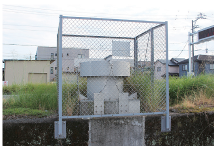
写真-3 雨水が噴出した空気抜き部
