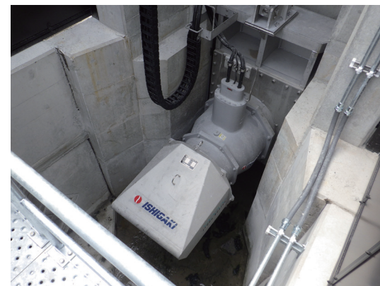
写真-2 排水ポンプ
