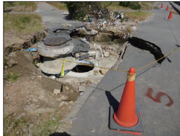
写真-1 人孔破損状況
