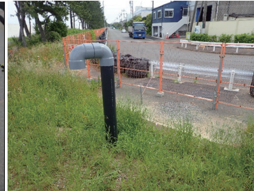
写真-2 被災後の対策 (エア抜き管)
