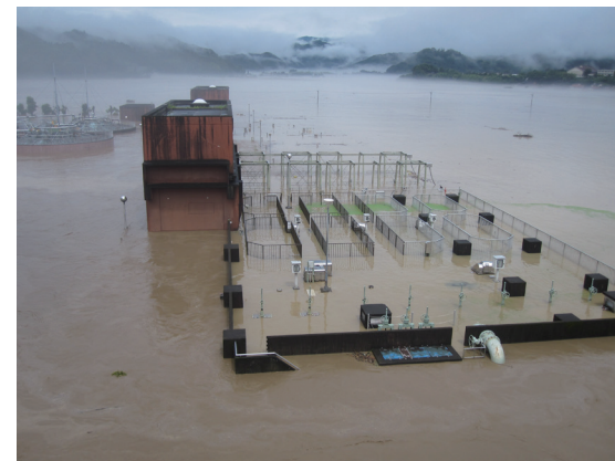
写真-1 全ての施設が浸水した人吉浄水苑
