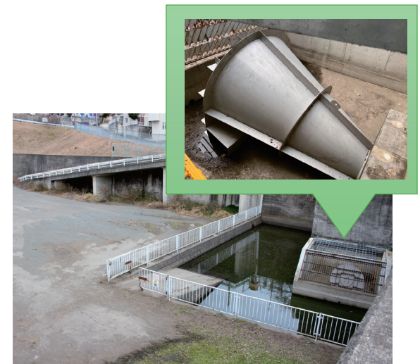
写真-1 日向岡2号調整池（ボルテックスバルブは長さ約2.5m、直径は大きい径で約1.5m、小さい径で約0.4m）
