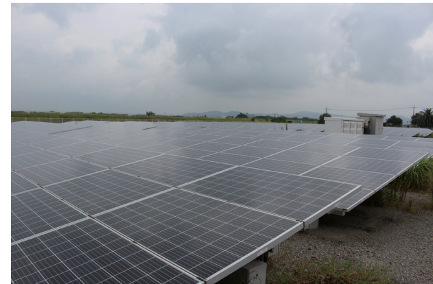
写真-1 岡東浄化センター内の太陽光パネル
