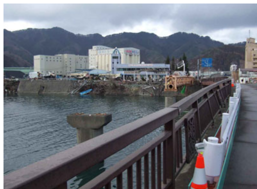
釜石市水管橋の破損
