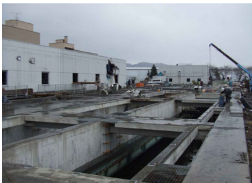
大船渡浄化センター (終沈、機電破損、土木被害なし)
