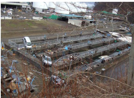
釜石市大平浄化センター(エアタン、終沈)
