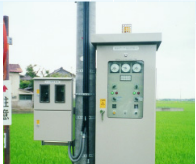
制御板の設置状況（写真提供：稲敷市，(株)日水コン）
