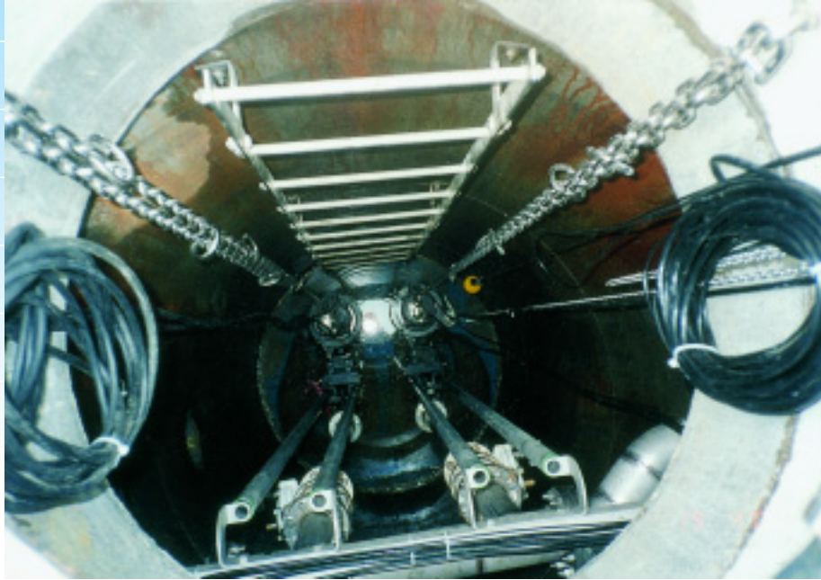
マンホール内に設置されたポンプ設備
