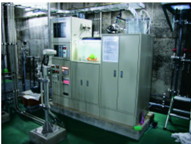
金魚を使った水質安全常時監視設備
