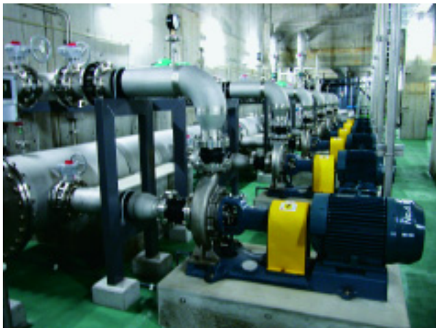
圧送ポンプは45kWのものを全部で6基設置
