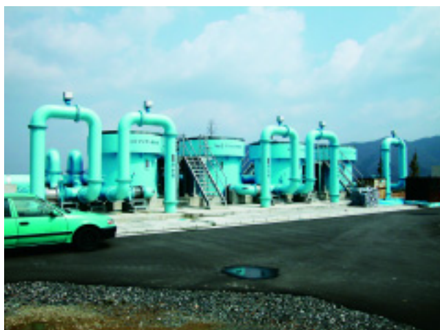
水に溶けたマンガンを析出させるためのマンガン接触塔
