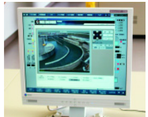
パソコンの画面で、施設の全ての監視・制御が出来る最新システムが導入されている
