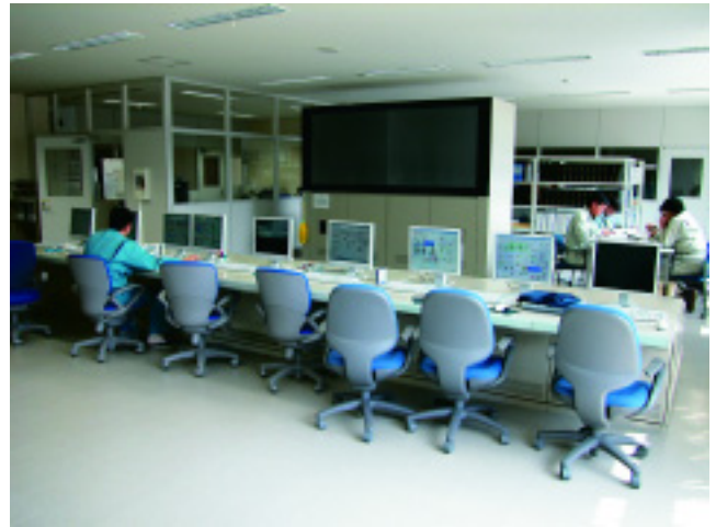
全ての作業を自動制御するコントロールルーム
