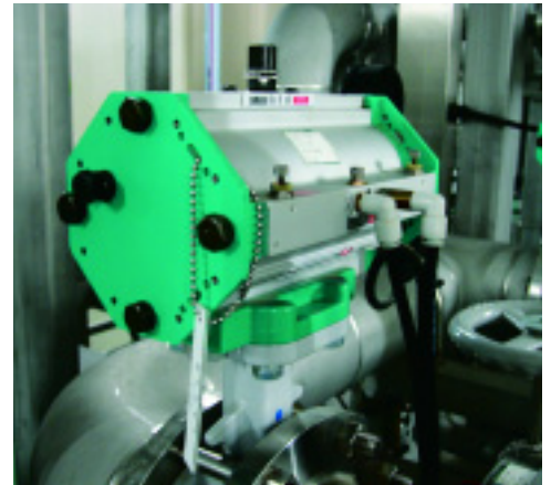
結露を考慮して電気式ではなく空気圧式のパルプを採用している
