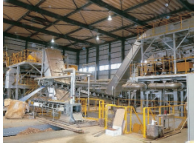
木材を破碎する前処理設備は日量180tを処理する
