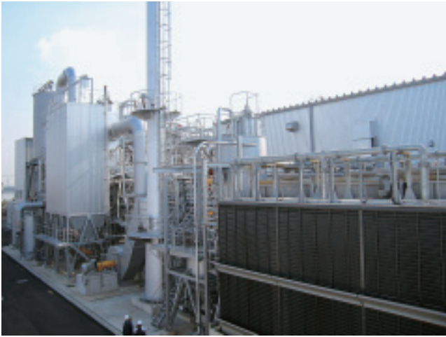
ボイラーによって施設内で使う蒸気と電力をつくり出す
