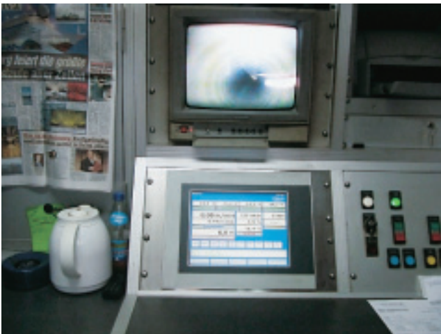
車載型のコントロールルーム
