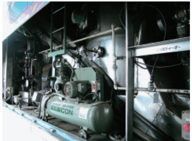
車載式高効率汚泥乾燥設備の内部
