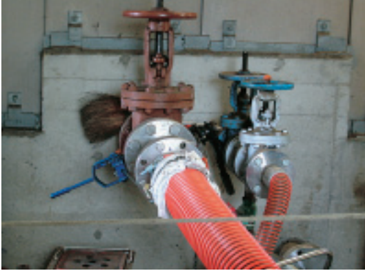
圧送管で脱水汚泥が供給される
