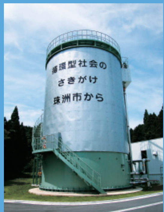
有機物を分解するための発酵槽 (中温37℃、消化日数約20日)
