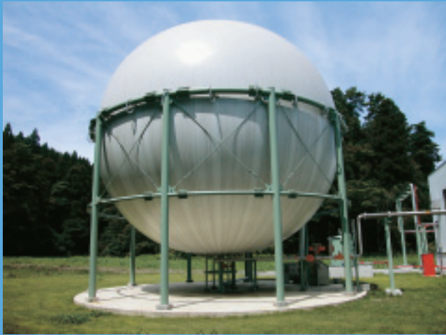
発生したバイオガスを貯蔵するガスタンク
