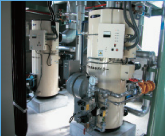
発酵槽加温用の温水ボイラ
