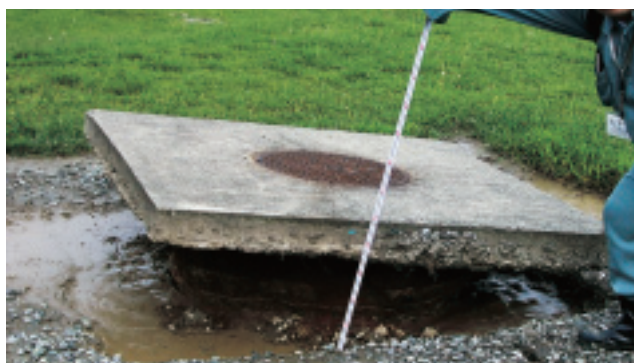
液状化による場内汚水マンホール突出状況
