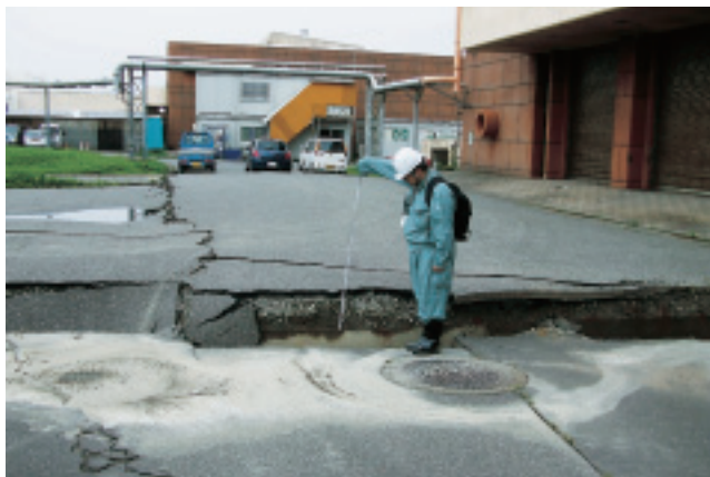
液状化による噴砂とそれに伴う地盤沈下状況
