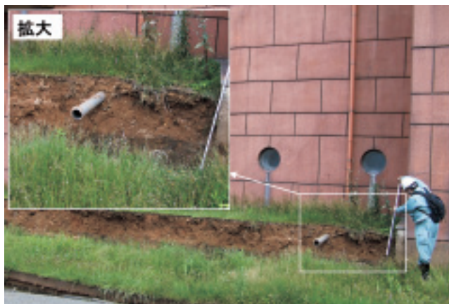
地盤沈下による中央管理棟と基礎部の露出状況
