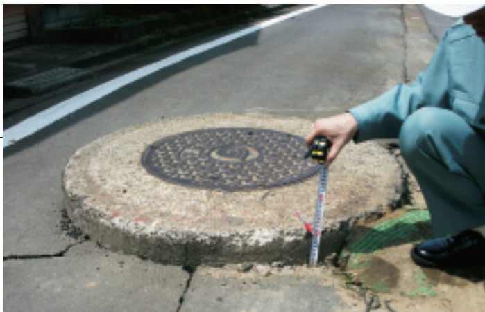
マンホール突出状況（柏崎市西山町）
