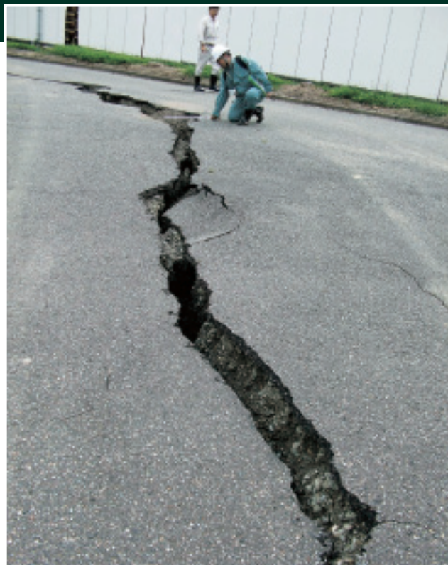
場内道路の被害状況（き裂）
