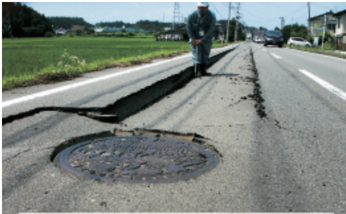
汚水管埋設箇所における道路路面陥没状況（柏崎市西山町）
