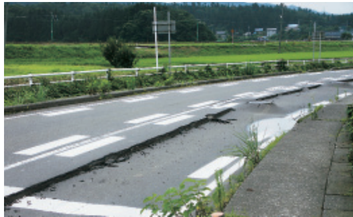
汚水管埋設箇所における道路路面陥没とマンホール突出状況（柏崎市西山町）
