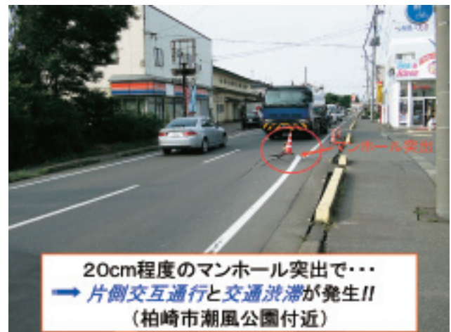
写真一2 マンホール突出に起因する交通渋滞
