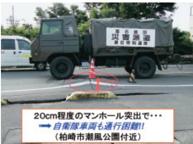
写真一1 マンホール突出による通行障害
