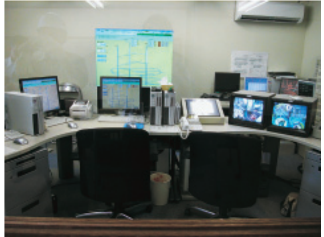
最新のモニター監視システムが並ぶ中央監視室
