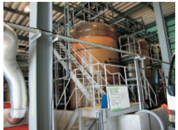
施設内から出る排水に含まれるホウ素を除去するためのキレート吸着塔
