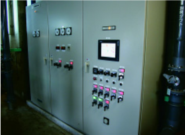
同室内に設置されたコントロールパネル
