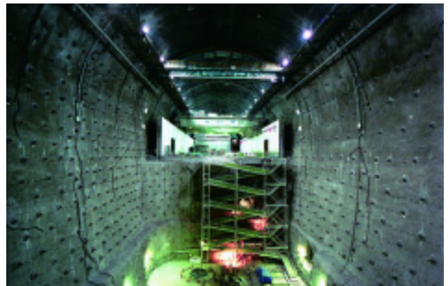
神流川発電所地下空洞は圧倒される大きさ
