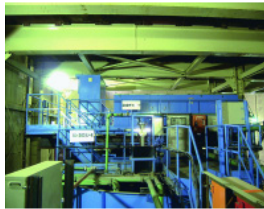
濃縮デカンタの下に濃縮スラリー槽がある
