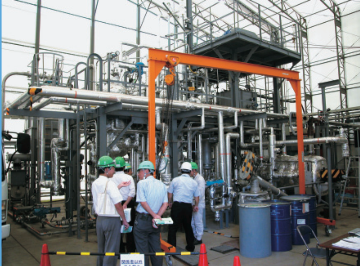
順調に稼働する改質乾燥による下水汚泥バイオマス燃料化プラント
