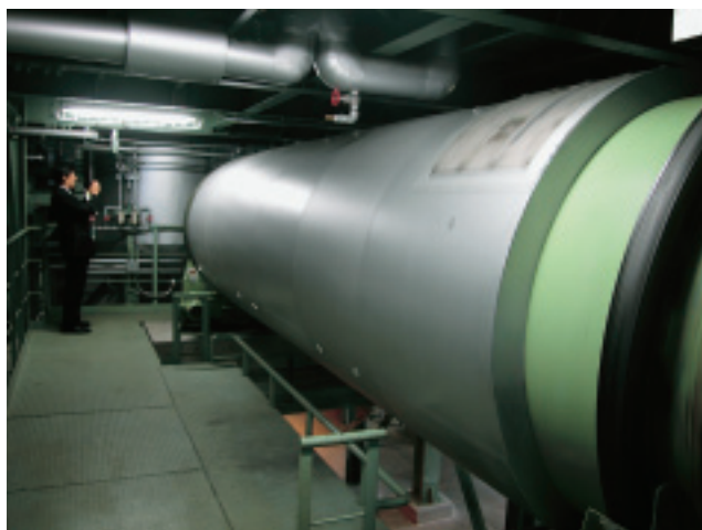
熱風を回転ドラムに吹き込んで 汚泥の含水率を8%以下に
