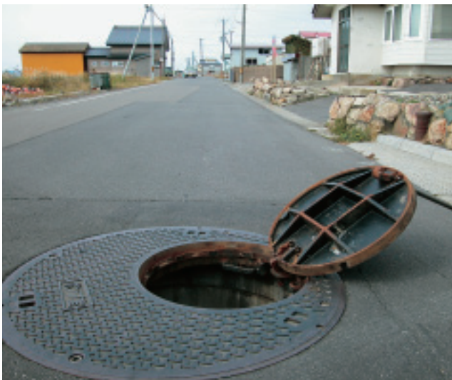
戸井地区の海岸線を走る道路下に設置された マンホールポンプ（小安第一ポンプ所）
