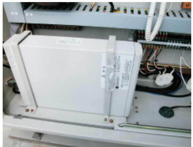
停電などの非常時に一定時間電源を供給する 無停電電源装置UPS
