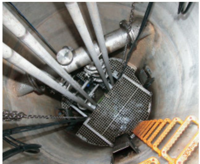
小安第一ポンプ所（吐出量2.154m 3 /min）の内部の状況
