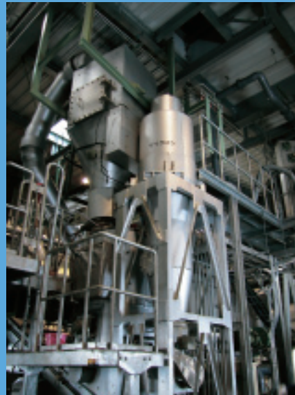
乾燥汚泥をサイクロンで補集して解砕機に供給する
