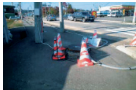
汚水の溢水対策として仮配管、仮排水ポンプによる応急復旧状態
