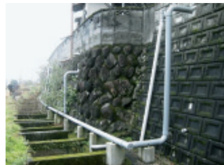
露出配管の配管例
