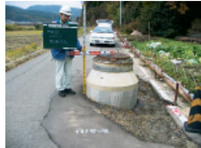
マンホールの突出被害（能登半島地震）
