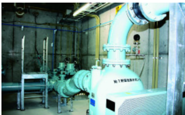
貯留池の排水ポンプ
