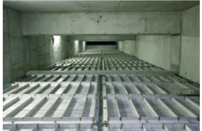
ろ過池の上部スクリーン。この下にろ材が入っている
