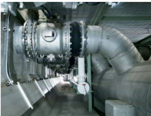
高速洗浄装置の開閉部
