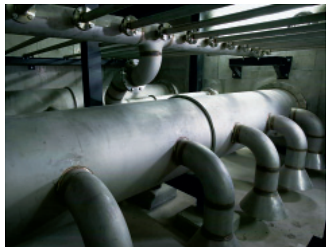
洗浄排水を集める高速洗浄装置の集水部
