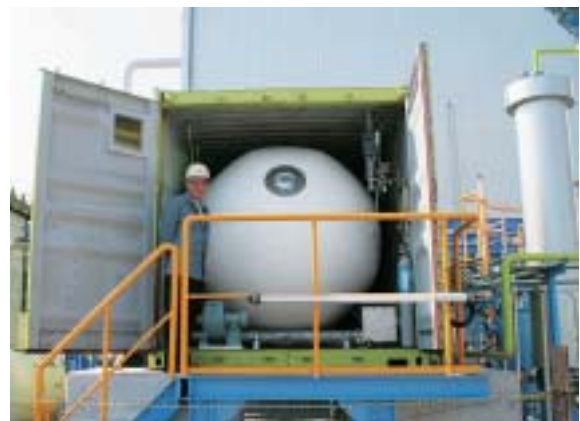
二層構造になっているバ ルーン型のガスホルダー
