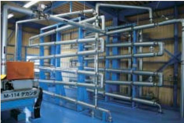
廃熱を回収し再利用している
