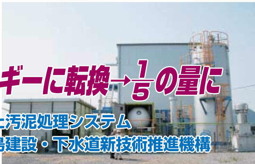
汚泥のエネルギー転換・減容化が行われている亜臨界水処理実証プラント
