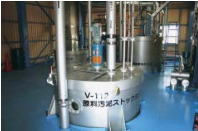
タンクヤード。手前が処理場からの濃縮汚泥、奥の左が濃縮スラリー、右がメタン発酵の原料汚泥
