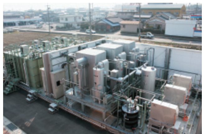
見合ポンプ場に設置された槽外型MBR実証プラント
