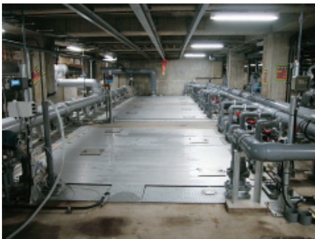
好気槽の下には4,800枚のMF膜が設置されている
