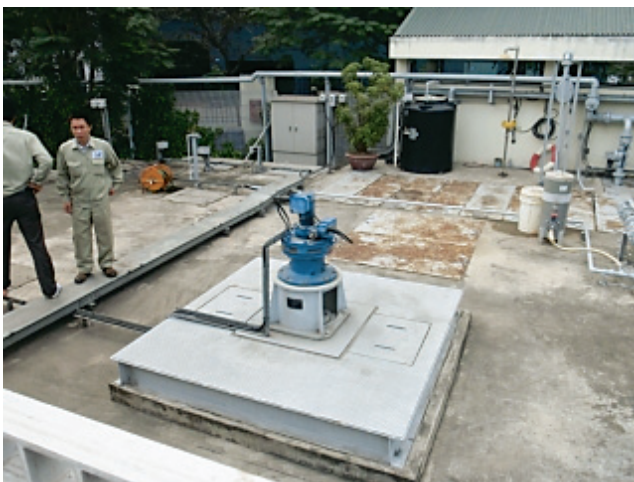
ハノイ市トゥック・バック下水処理場最終沈殿池
