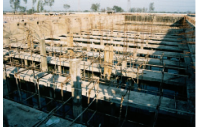
写真-4 下水処理場建設, ファリダバッド, UASB法, 能力45,000m 3 /日, 反応槽, 1997年
