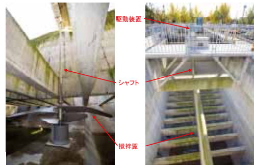
写真-1 設置例（タンク内部） 写真-2 設置例（タンク上部）
