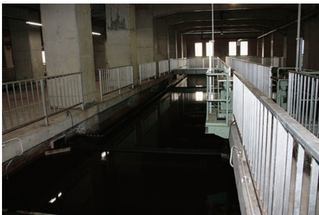
実機が設置された沈澱池
