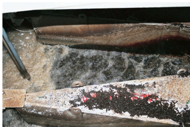
担体が投入されている好気槽の状況
