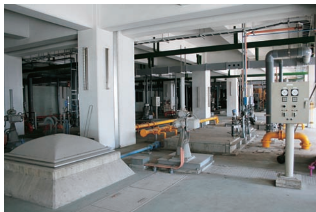
高度処理施設として稼働中の新1系水処理施設
