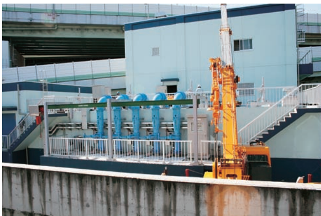
再生水をつくる繊維ろ過棟
