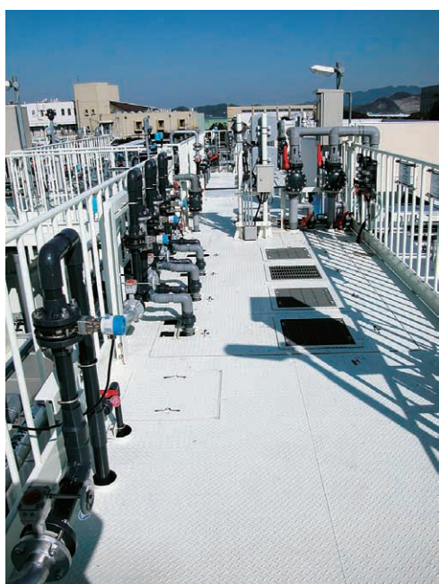
デモプラントのMBR水処理槽の上部
