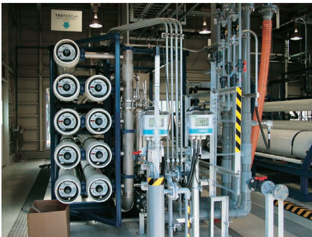
MBR処理水から生産水をつくる低圧RO膜ろ過設備
