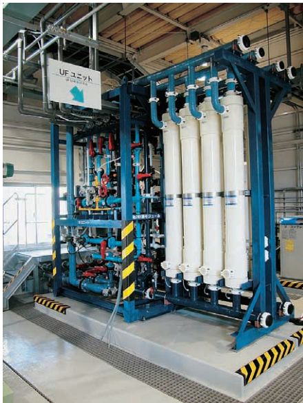
海水から細かな汚れを取り除くUF膜ろ過設備
