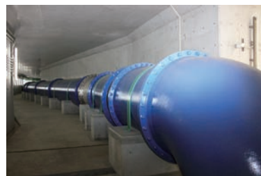
汚水を水処理施設に送水する導水渠。パイプの口径は1500mm
