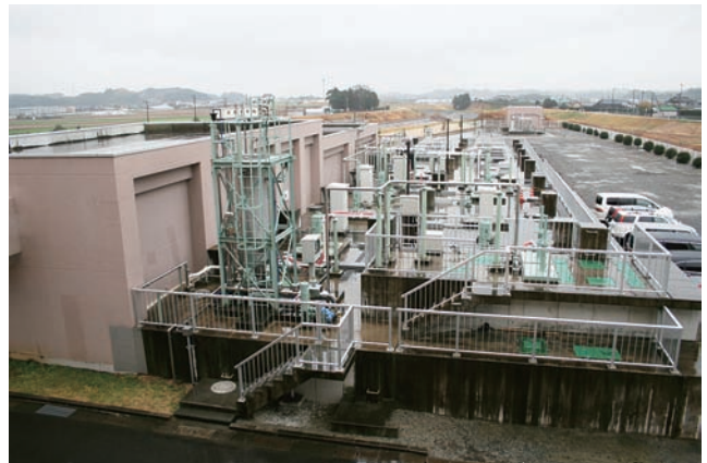
菊川浄化センターの水処理施設全景
