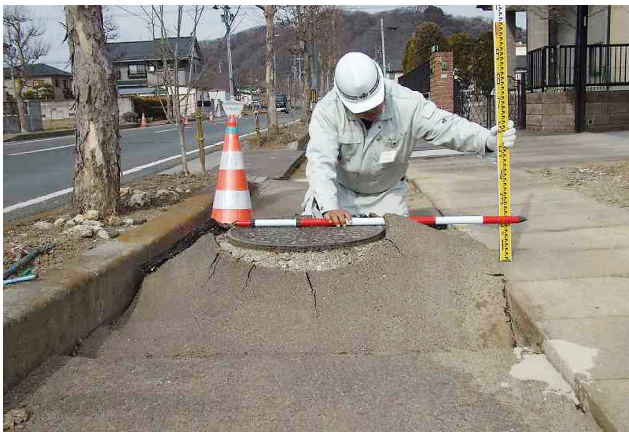
柴田町の人孔の突出，道路陥没
