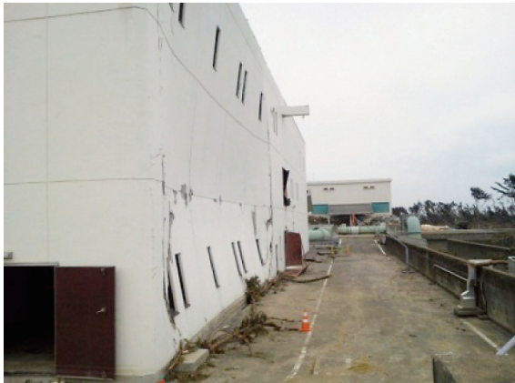
波力による被害状況
