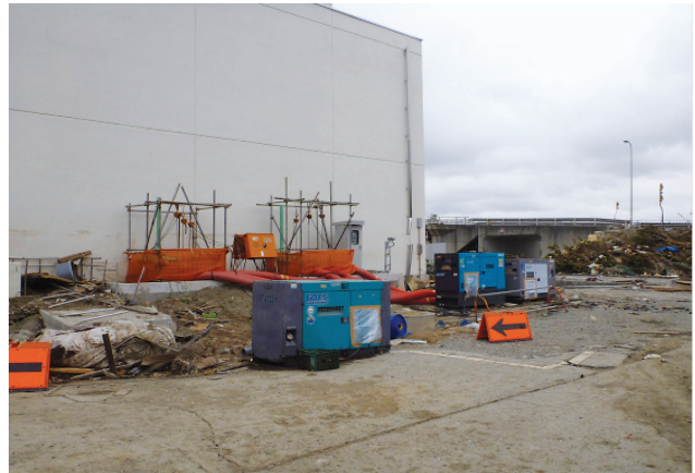
仮設発電機の設置状況
