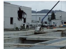
津波漂流物による被害
