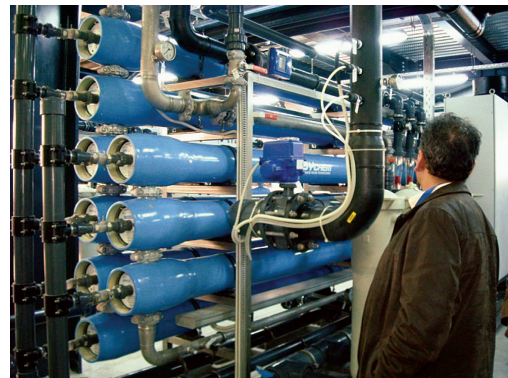
テクニカルツアー・逆浸透膜装置
