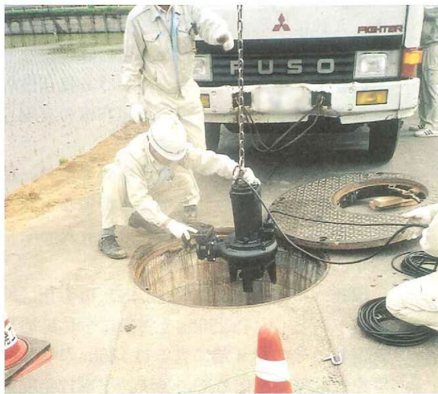
クレーンでつり上げられ、マンホール内に降ろされるポンプ設備
