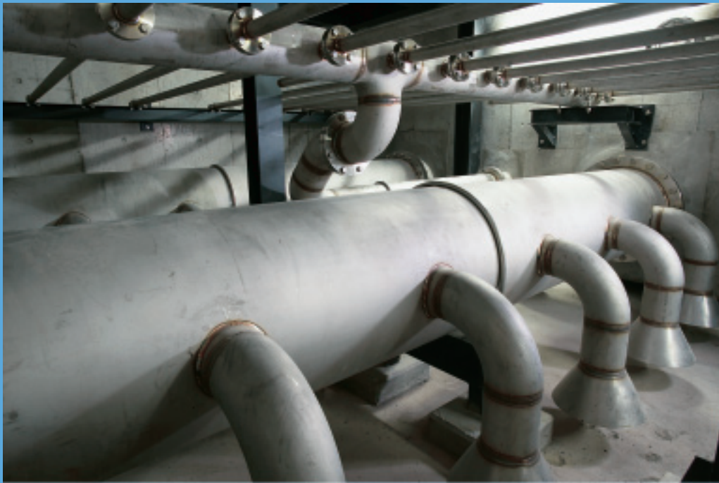
洗浄排水を集める高速洗浄装置の集水部
