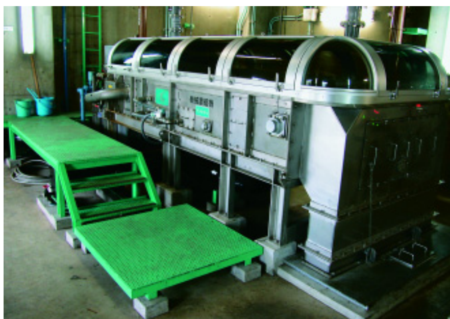
安定した運転を続けるベルト型ろ過濃縮機
