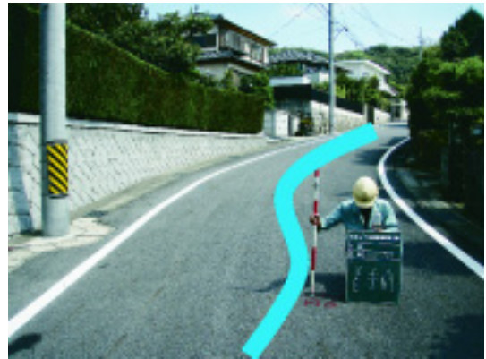
写-2 道路線形に沿った管きょ施工箇所 曲線道路 (愛知県岡崎市)
