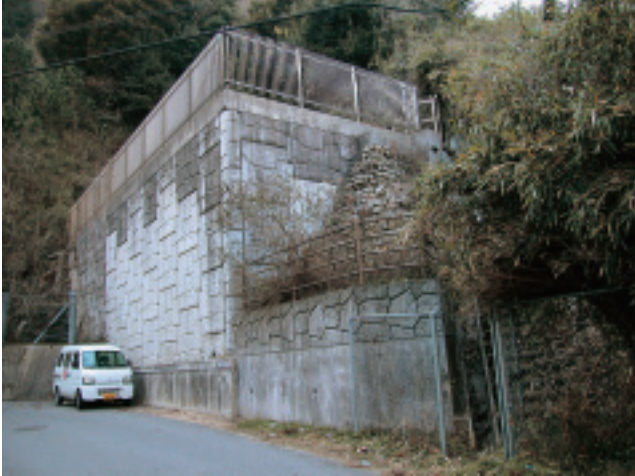
山腹に整備された減勢工・ドロップシャフト設備
