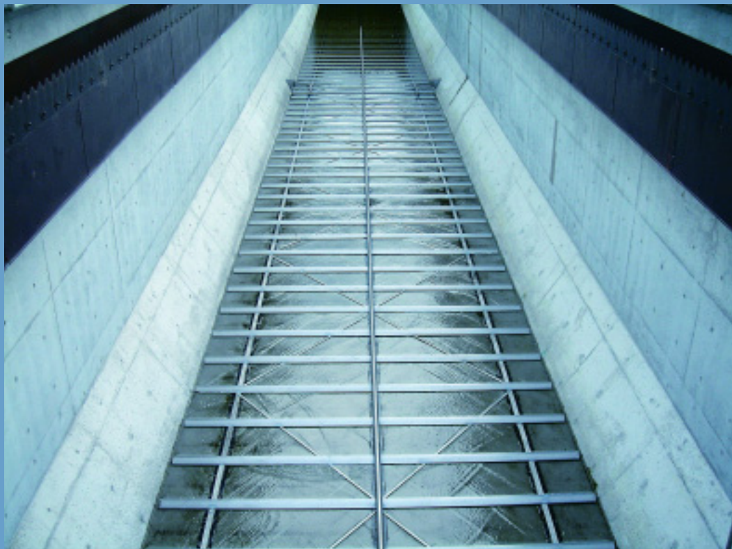
宮城県・仙塩浄化センターでの設置例
