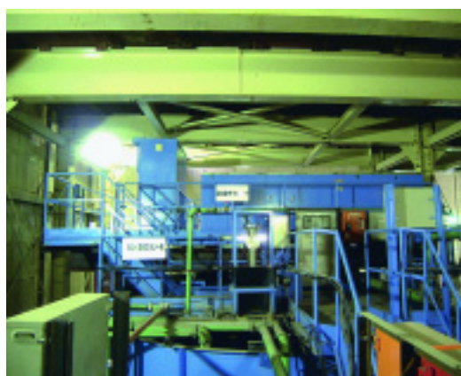
濃縮デカンタの下に 濃縮スラリー槽がある
